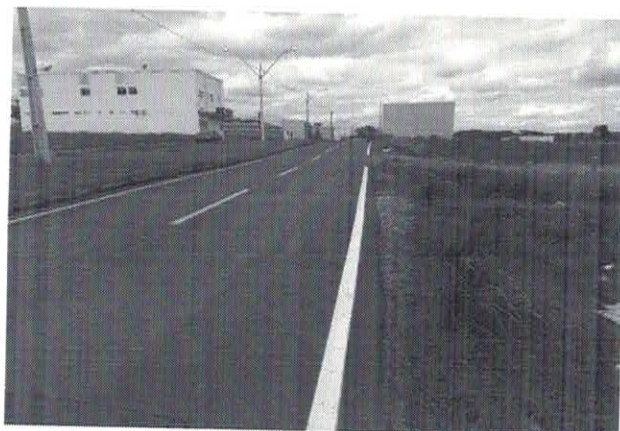
Imagem 3: Via com ausência total de meio-fio
