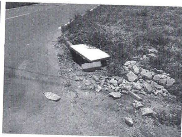
Imagem 2: Bueiro degradado, e ausência de meio-fio
