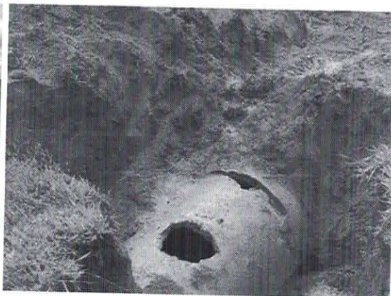
Imagem 4: Manilha danificada provavelmente pela força da água
